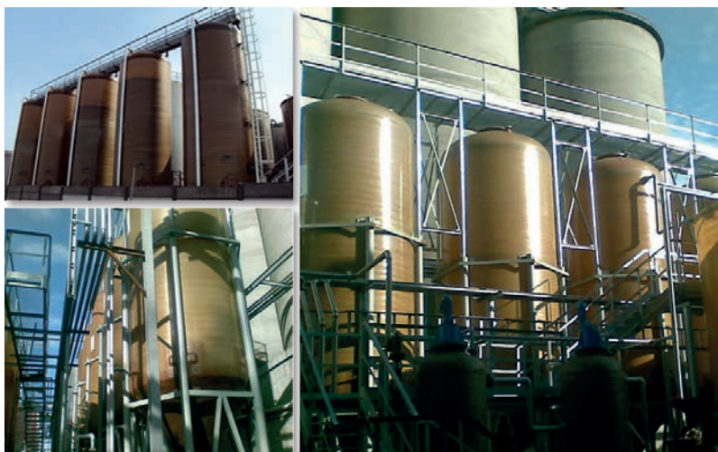
Batteria costituita da n. 5 serbatoi verticali fondo piatto capacità 50 mc e n. 4 serbatoi verticali fondo conico capacità 100 mc
