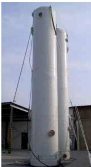
COLONNE DI STRIPPAGGIO ALTEZZA 11 m
