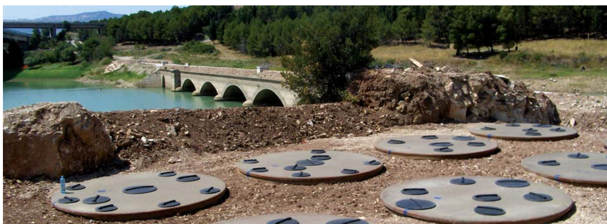
Impianto universale a portata costante per scarichi civili, con potenzialità di 360 AE, costituito da 10 vasche e clorazione finale.
