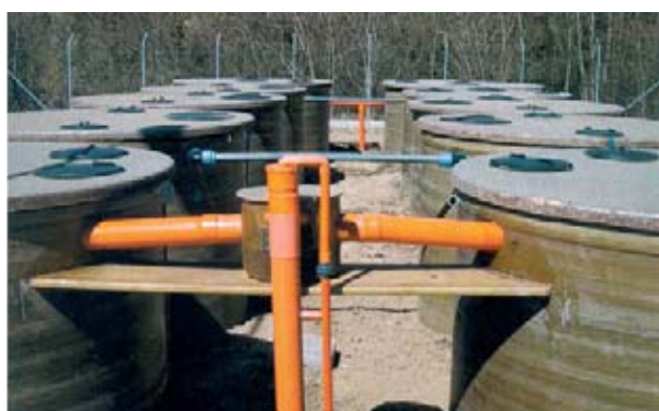
Impianto universale a portata costante per scarichi civili, con potenzialità di 300 AE, costituito da 11 vasche.
