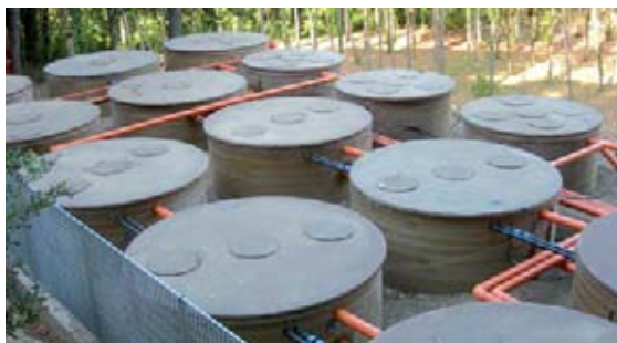
Impianto universale a portata costante per scarichi civili, con potenzialità di 500 AE, costituito da 15 vasche.
