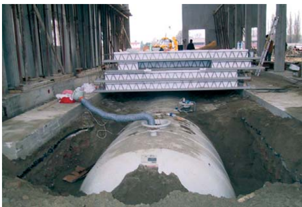
Impianto antincendio Centro Olimpico TORINO 2006, costituito da due cisterne da interro serie acqua in vetroresina. Capacità specifica di 50 mc.
