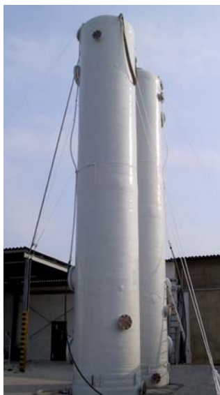
COLONNE DI STRIPPAGGIO ALTEZZA 11 m
