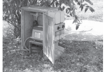
Esempio di locale tecnico
